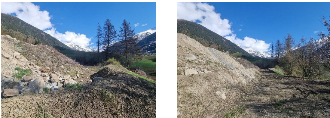
Illustration 7 : Rigoles d'infiltration en bas de pente
